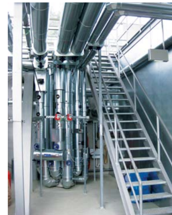
Innenansicht des Heizhauses (Foto: BIOBETH)
