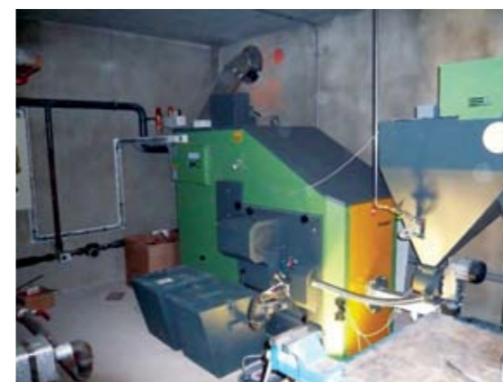
Biomasseanlage Eichenhof (Foto: Torsten Groß)
