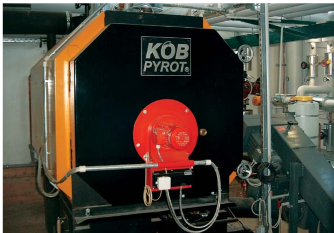
Holzhackschnitzelkesselanlage des Schulkomplexes in Dörnfeld (Foto: Gemeinde Ilmtal)
