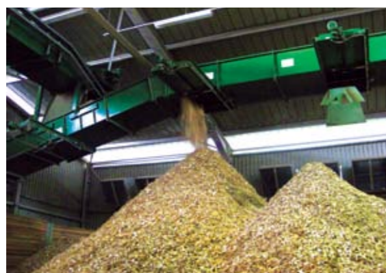
Ein Förderband für Holzschnitzel im Biomasseheizkraftwerk Schkölen (Foto: BIOBETH)
