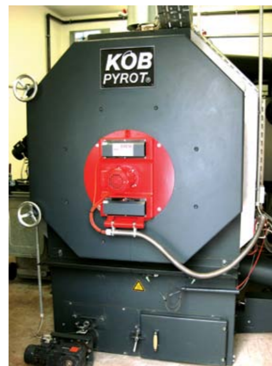
Heizkessel (Foto: BIOBETH)
