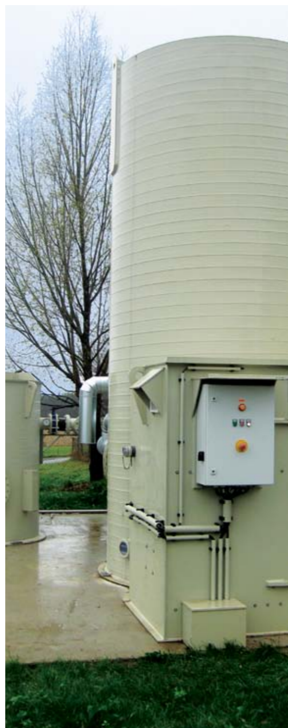
Biogasreinigung (Foto: BIOBETH)
