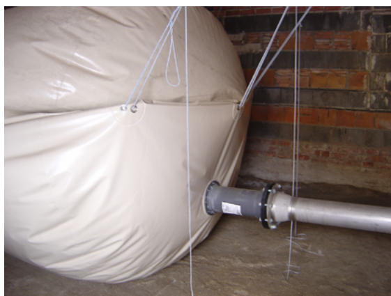
Abb. 12: Einschaliger Gassack mit Befestigungen (© Gerd Reinhold)
